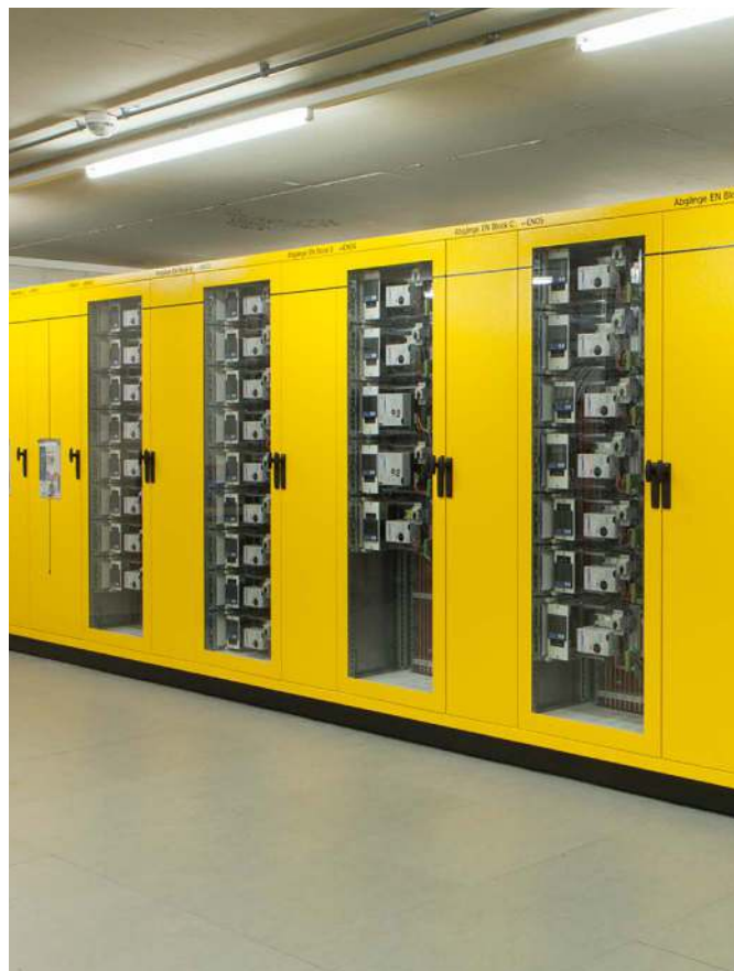
Hauptverteilung in einem Bankgebäude
